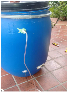
Figura N°9.16 - Resistencia, Sensores de Temperatura y Presión.
